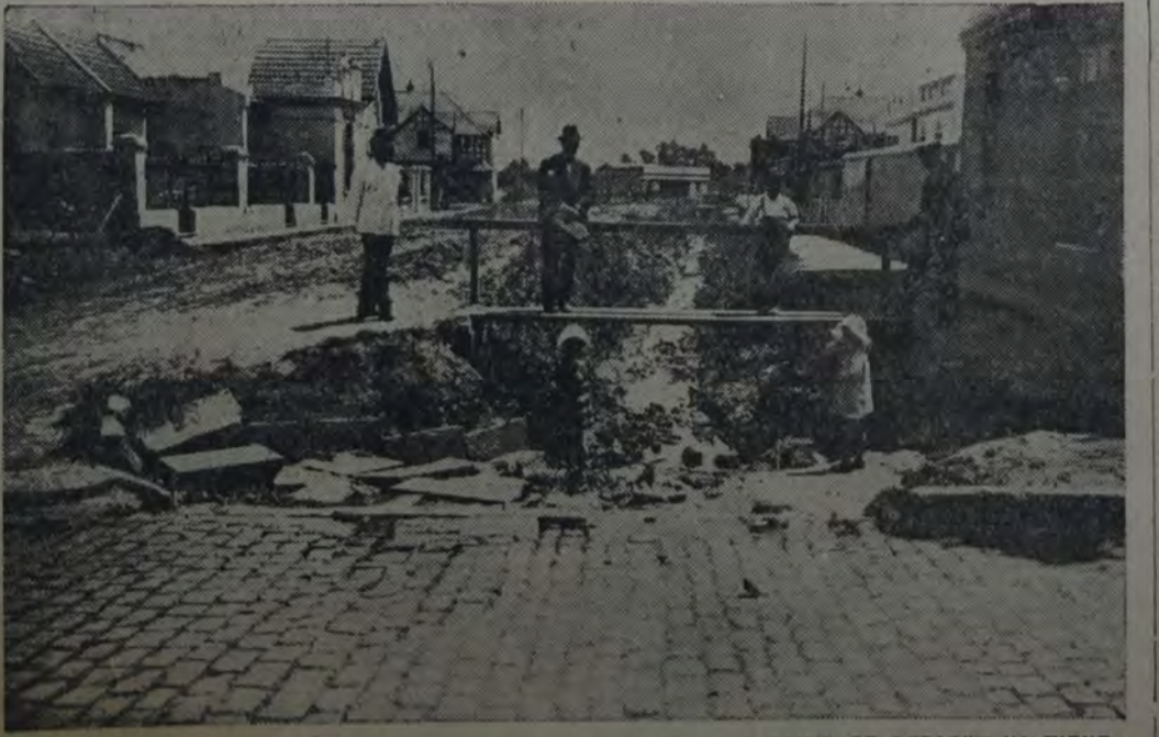
CALLE GENERAL JOSE G. ARTIGAS Y AVENIDA SAN MARTIN. LA ZANJA DE DESAGUE NO TIENE salida. A causa de ello, la avenida San Martín se inunda con facilidad pasmosa. El puente es una obra notable de ingeniería municipal. La "maquette" podría ser mandada a alguna exposición internacional de urbanismo. Ganaría el primer premio, seguro! (Ver la interesante nota que va en la página 6).
